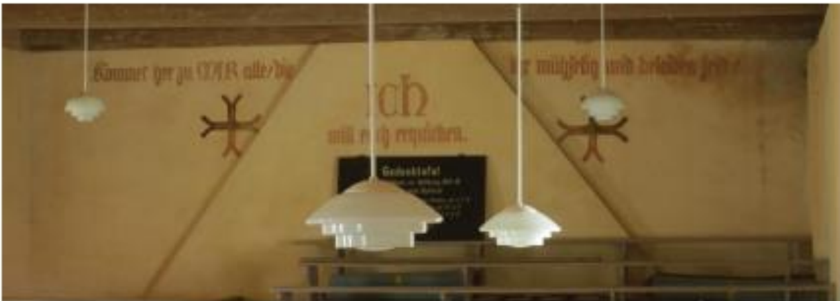
Abb. 6 Schriftzug an der Westwand oberhalb der Empore, rechts oben mit bräunlichen Wasserflecken, sonst in gutem Zustand
