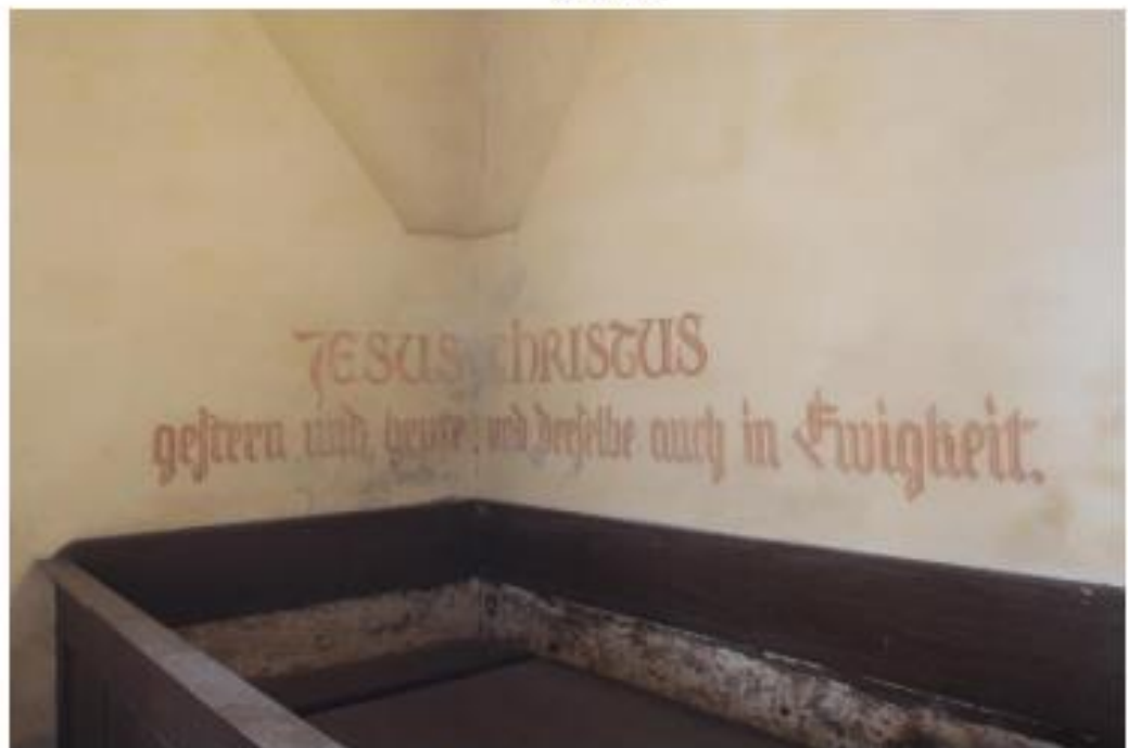
Abb. 4 Schriftzug an der Rückwand des Pastorenstuhls, Der Putz ist durch Salzkristallisationsprozesse beschädigt.
